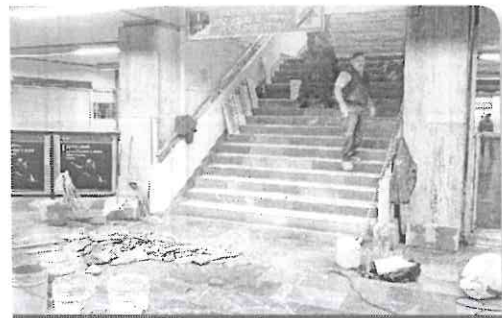
Trabajos de reemplazo de mármol en las escaleras fijas durante este fin de semana.
