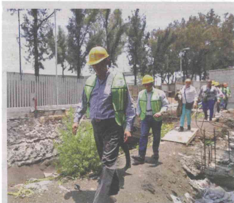
Las autoridades verificaron la suspensión de la obra junto al Cetram; el terreno recuperado mide 922 metros cuadrados.
