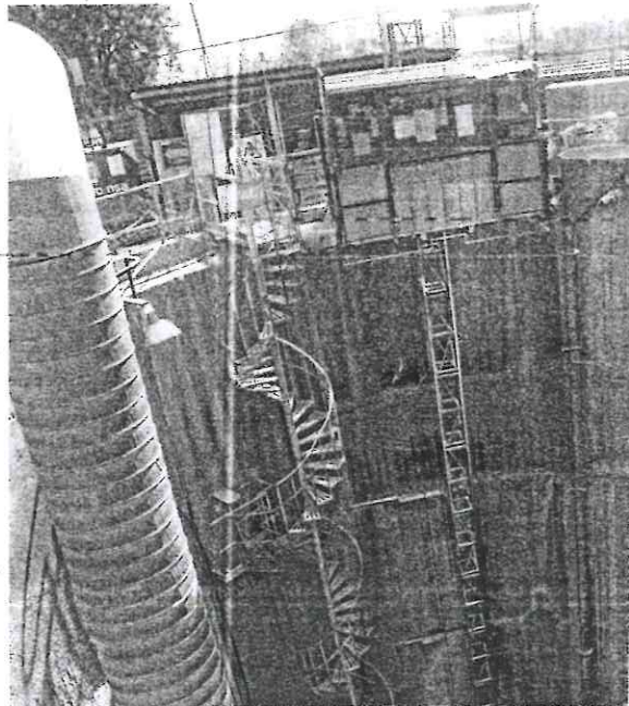
La lumbrera 4, obra suspendida, está cerca de la colonia afectada/DANIEL HIDALGO
