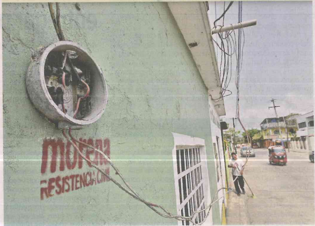
DIABLITO. Caja sin medidor en una calle de Buenavista, comunidad de Villahermosa.
