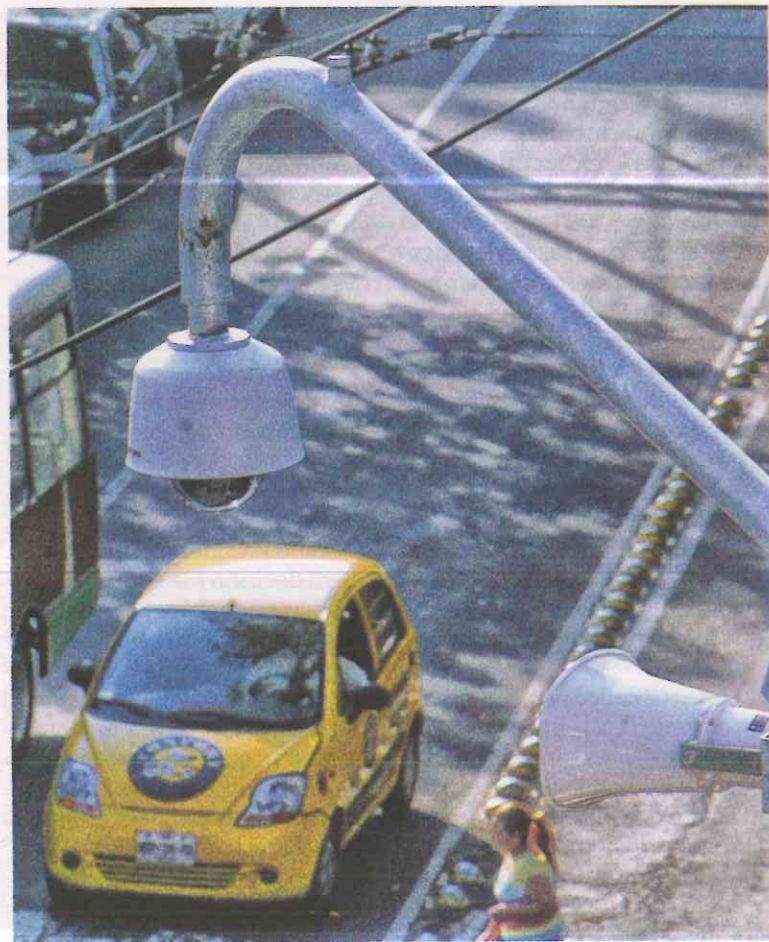
FALLAS. De los 15 mil 310 postes con equipos, 2 mil 500 los puso Seguritech.
