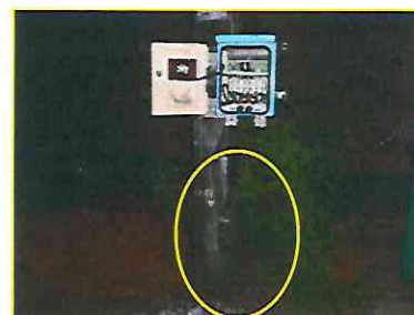
Caja con cableado hacia vías
