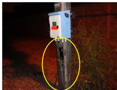
Caja con cableado hacia las vías
