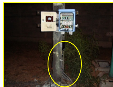
Caja con cableado hacia vías
