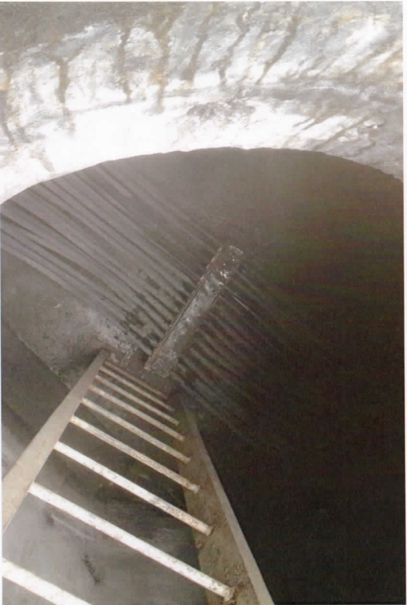
Foto No. 5.- Para entrar al registro, éste cuenta con una entrada circular cubierta con una tapa de placa de acero y una escalera metálica que desciende a nivel de los cableados.
