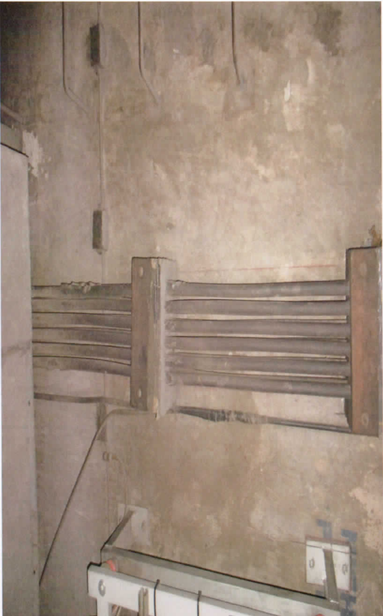
Foto No. 25.- Esta red de tierras es utilizada para conectar los bastidores de los equipos electromecánicos, (CTP), y los soportes y herrajes de soporte de los seccionadores y barra colectora del sistema de retorno de tracción.
