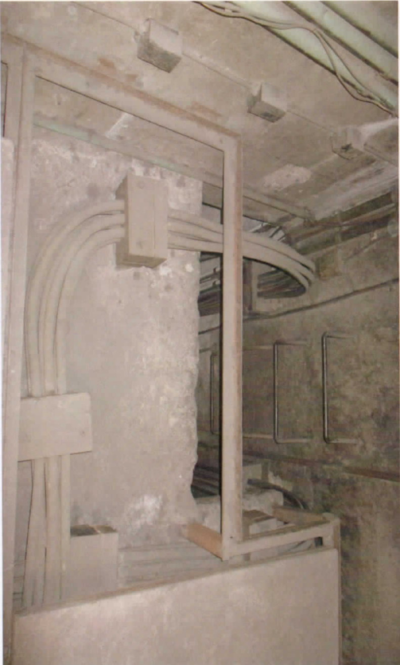
Foto No. 23.- Se ve al cable desnudo de cobre de la red de tierras, subir por el muro y penetrar al nicho de tracción, donde se distribuye por los muros, fijado por encapsulados de resina.
