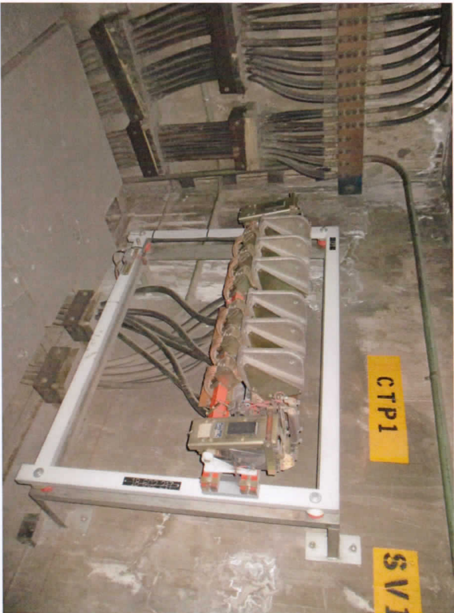
Foto No. 16.- El CTP 1, o contactor de tramo de protección de vía 1. Interior del nicho de tracción.
