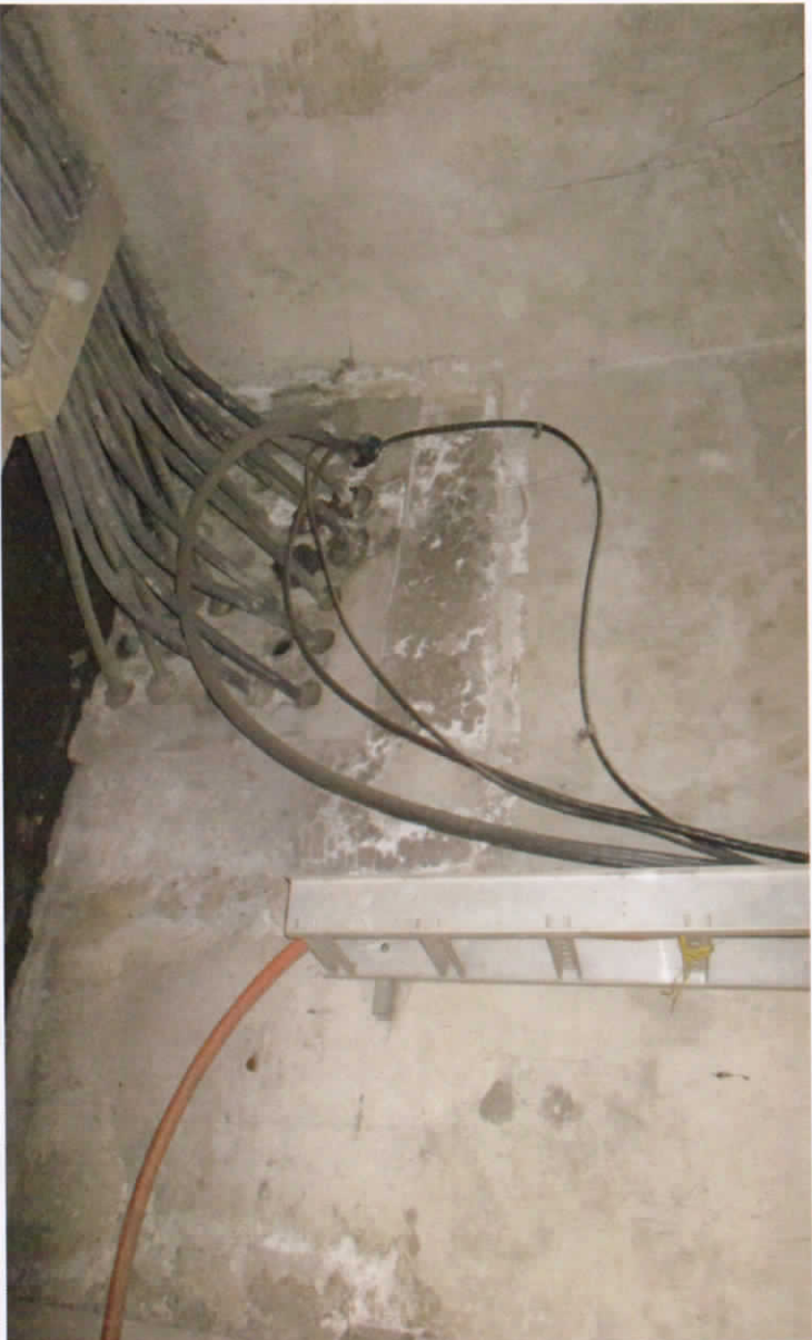
Foto No. 9.- Los cables del circuito de retorno entran al banco de ductos de asbesto cemento del lado izquierdo de la pared derecha del registro de la SR Peñón. También los cables de Baja Tensión y un cable de telefonía interna.
