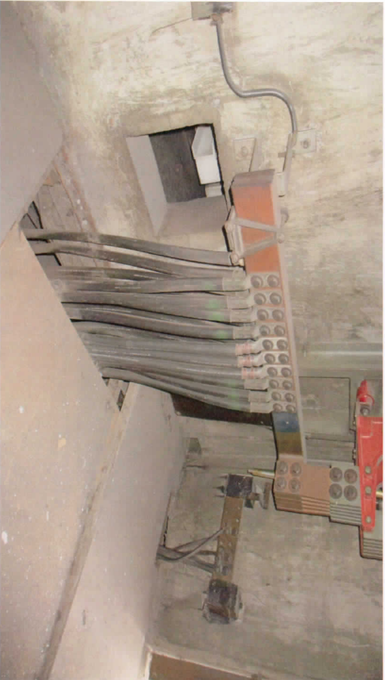
Foto No. 2.- Se observan los seccionadores de retorno, a la salida del equipo de rectificación de la SR Peñón. Los cables se dirigen al registro de la SR, por trinchera.
