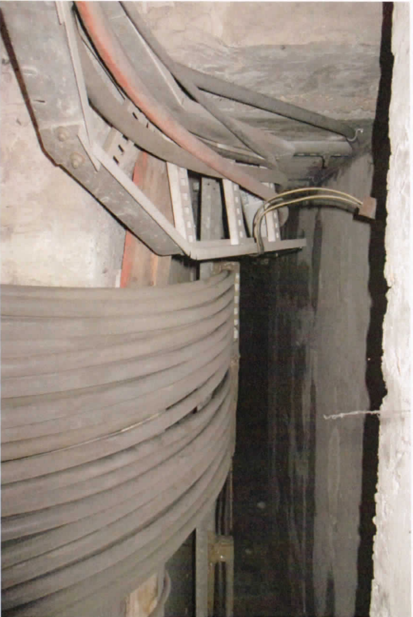
Foto No. 4.- Los cableados de Mando Centralizado, Baja Tensión y telefonía interna, llegan por medio de una charola de aluminio tipo escalera.
