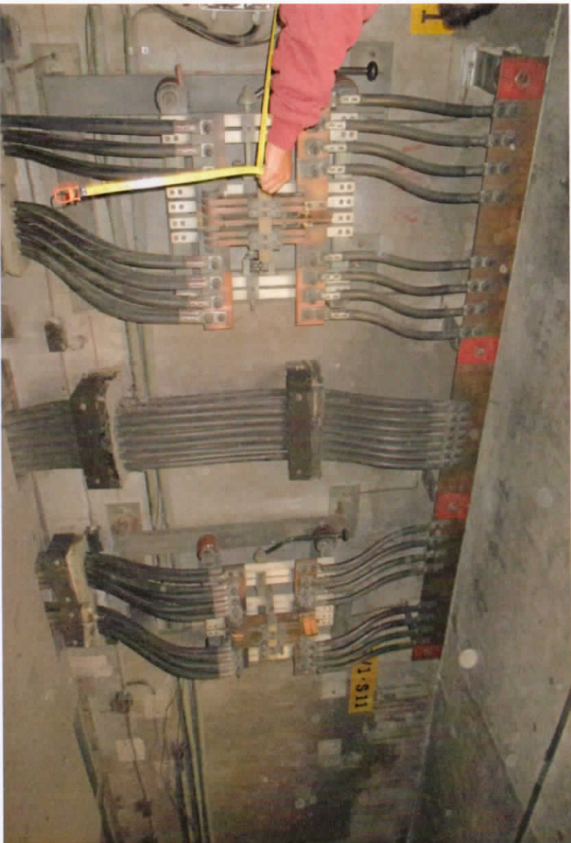
Foto No. 18.- Uno de los dos grupos de seccionadores manuales. Este corresponde al de la sección 11 S11. Interior del nicho de tracción.
