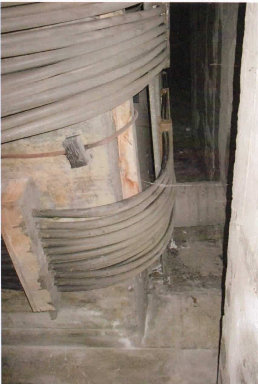
Foto No. 3.- Se observa la salida de la trinchera. Los cables de tracción desembocan en el registro de la SR, tanto los positivos como los de retorno, así como el cable desnudo de la red de tierras.
