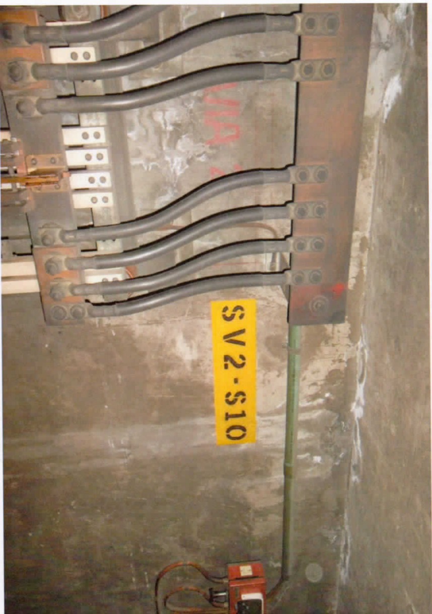
Foto No. 19.- Este es uno de los seccionadores del grupo que corresponde a la sección 10, S10. Interior del nicho de tracción.
