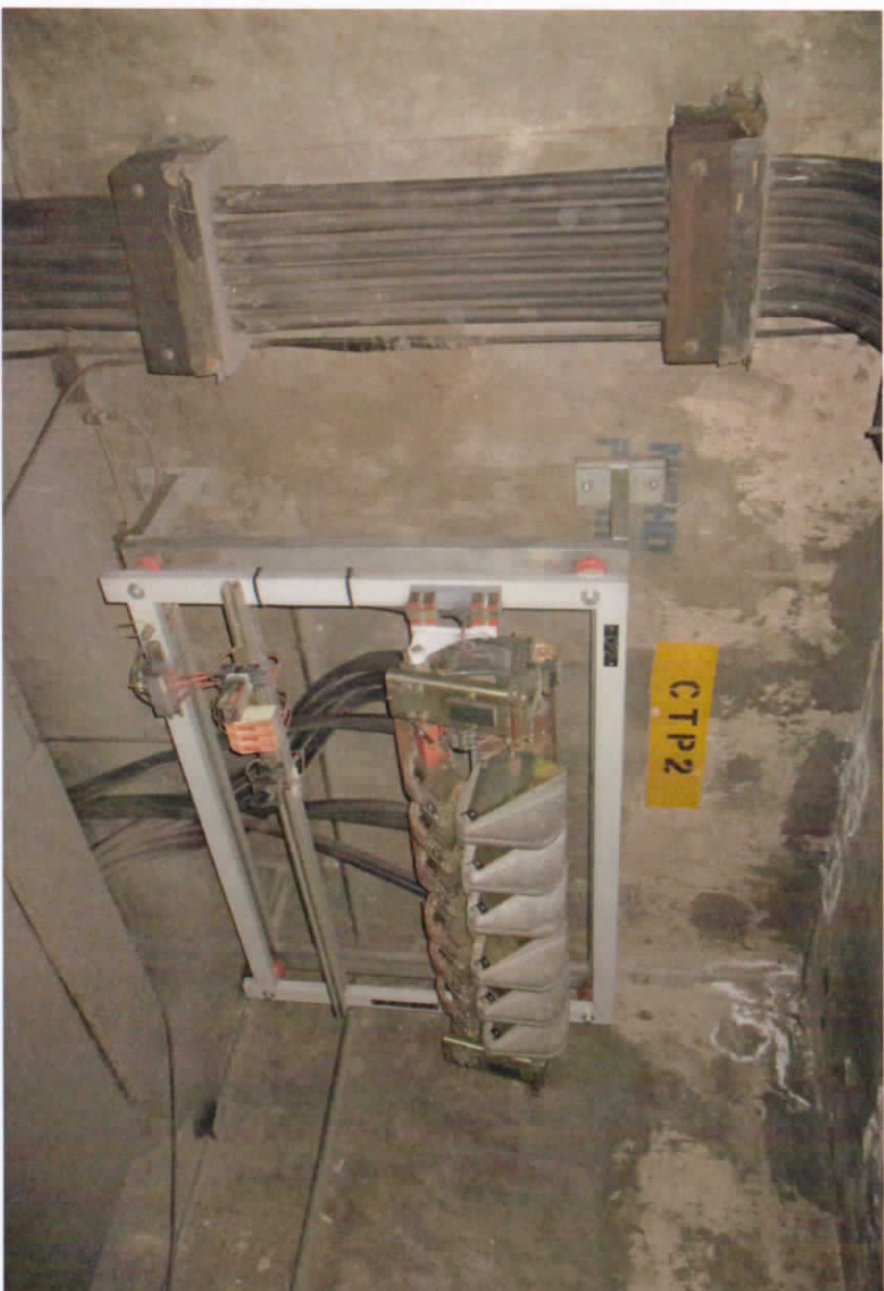
Foto No. 17.- El CTP 2, o contactor de tramo de protección de vía 2. Interior del nicho de tracción.
