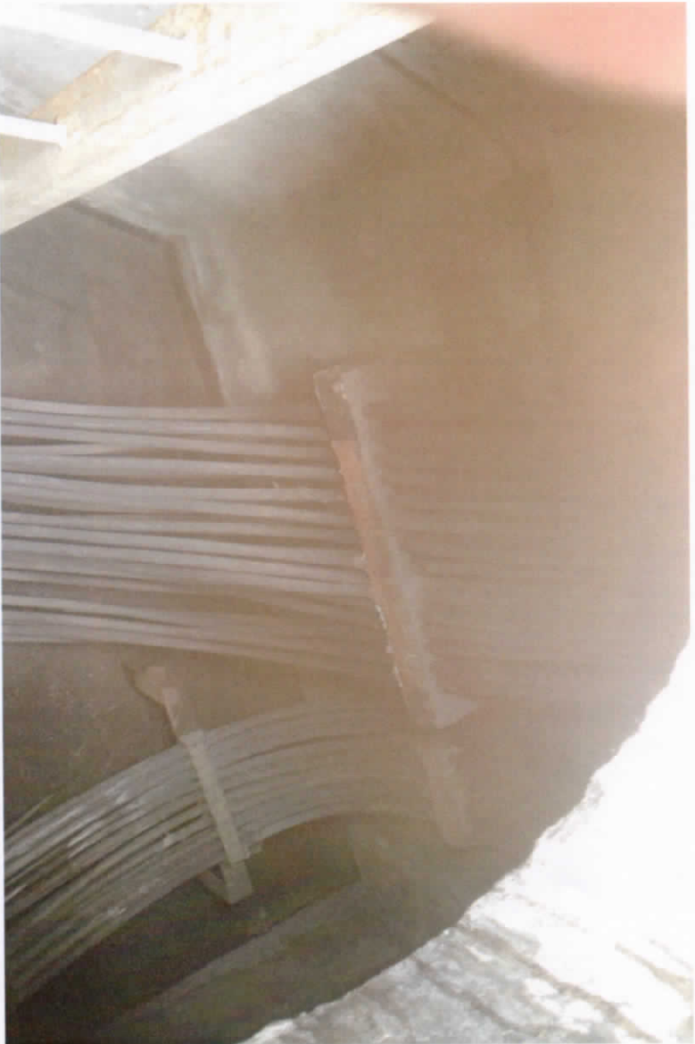
Foto No. 6.- Se ven los cableados de tracción descender sujetos por clemas de madera fijas al muro del registro.
