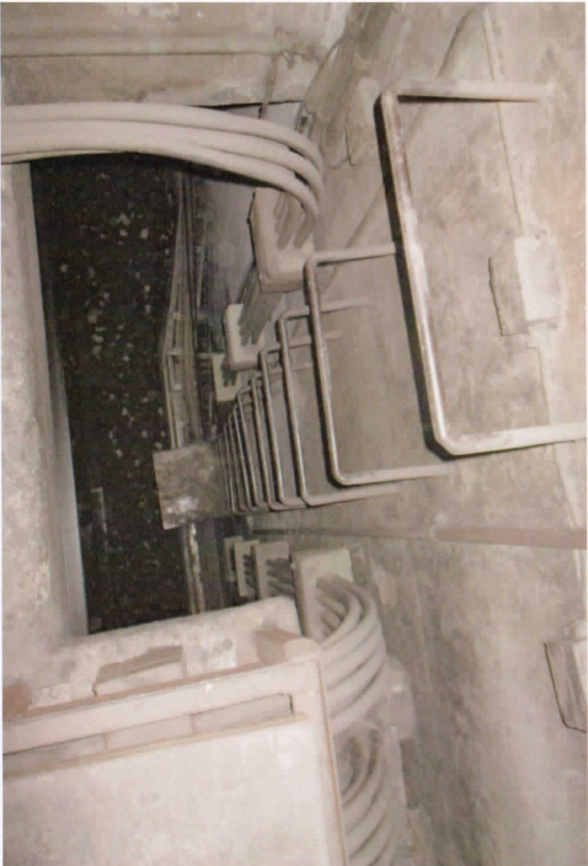
Foto No. 14.- Se ven los cables entrando al nicho de tracción, por huecos y directamente al piso falso del nicho.
