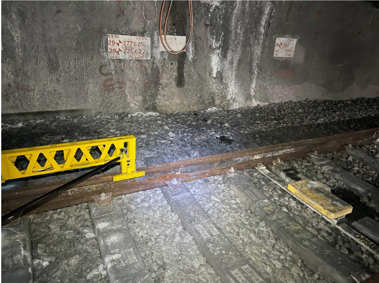
Figura 146. En cola de Estación Mixcoac, se encuentran los rieles con oxido.
