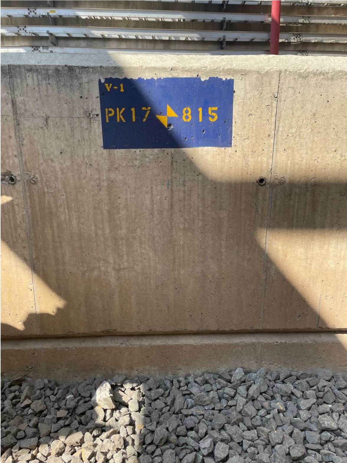
Figura 137. - Inicio de Medición en Cadenamiento PK17+815 en Vía 1en Sentido de Atlalilco – Mixcoac.
