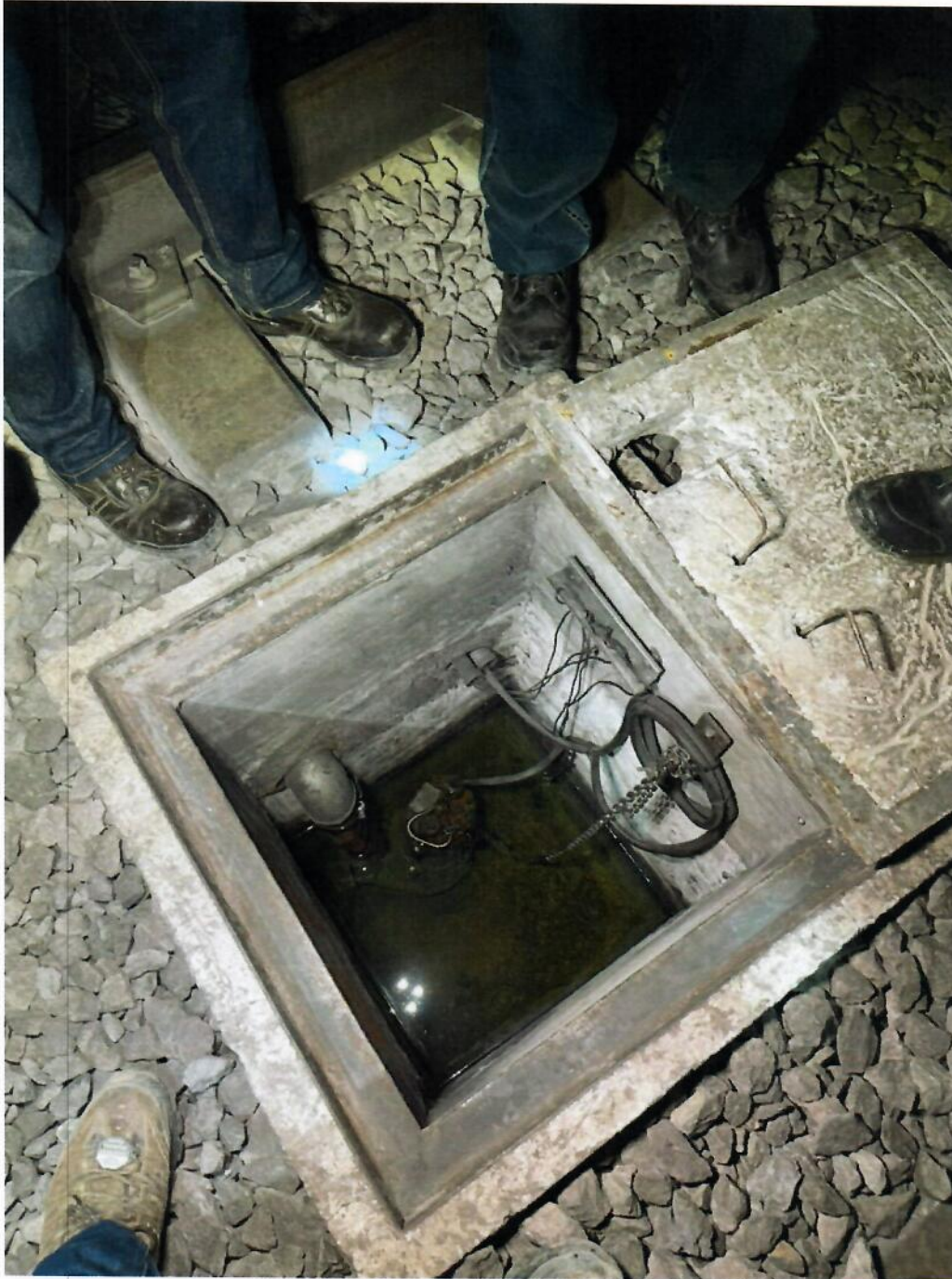
Fotografía 12. Bomba de achique instalada en el cadenamiento 24+470. Puede observarse que las tuberías se encuentran llenas y la bomba aún no estaba operando.
