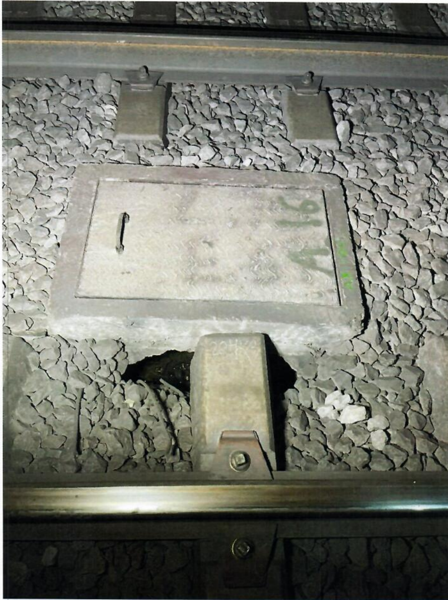
Fotografía 16. Falla estructural en las paredes del registro ubicado en el encadenamiento 20+400.
