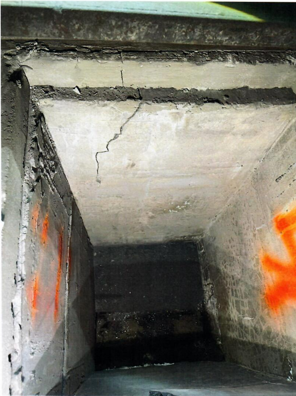
Fotografía 10. Agrietamiento en la paredes y azolve de materiales al fondo del registro de drenaje ubicado a la altura del cadenamiento 25+175.
