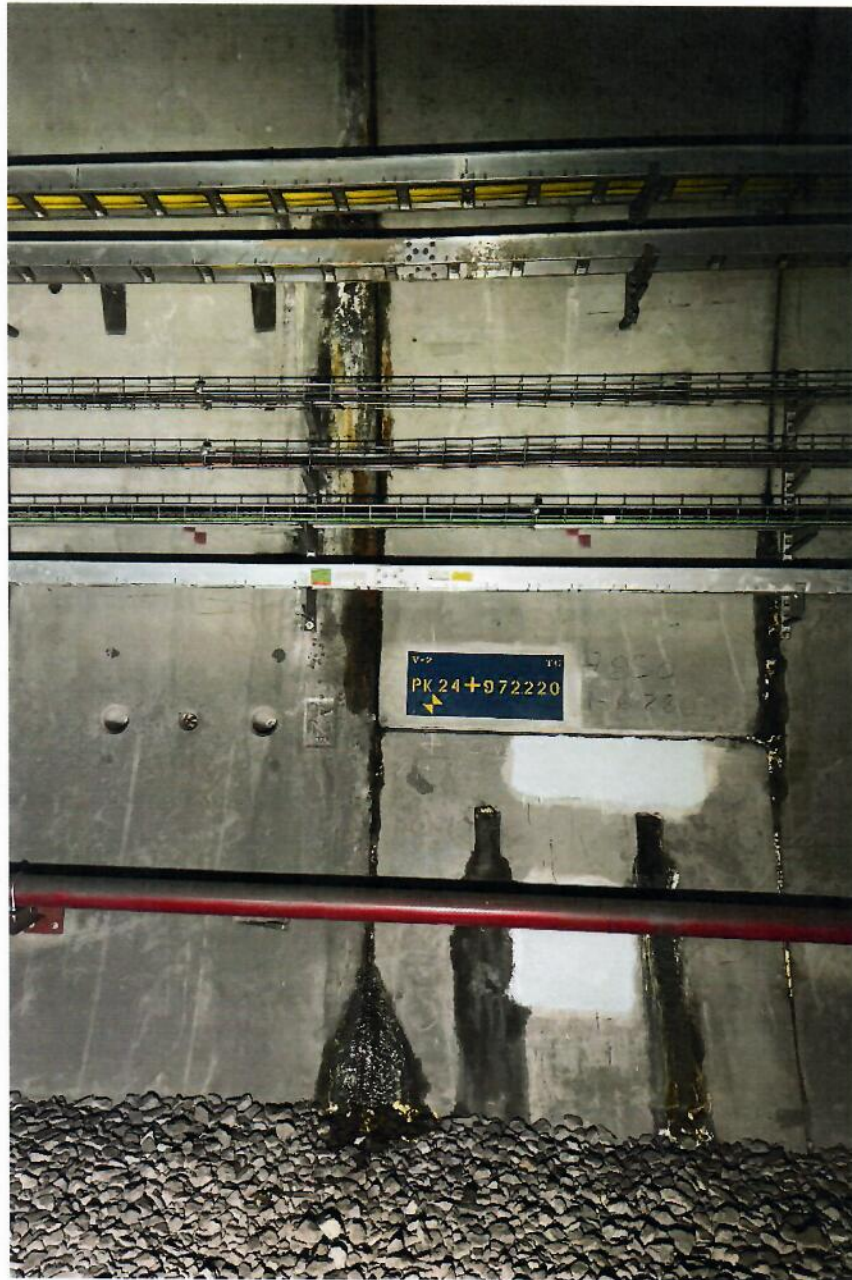
Fotografía 5. Filtraciones entre juntas a la altura del cadenamiento 24+972.
