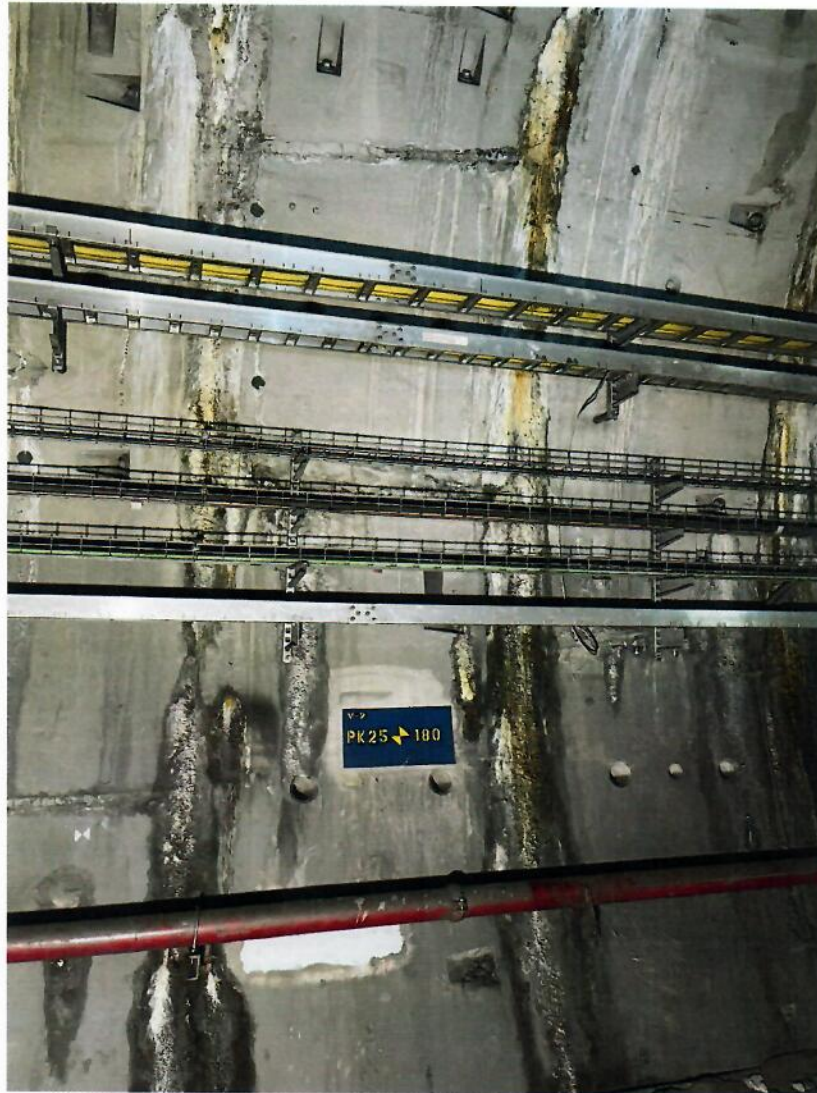
Fotografía 1. Filtraciones observadas en el cadenamiento 25+180.
