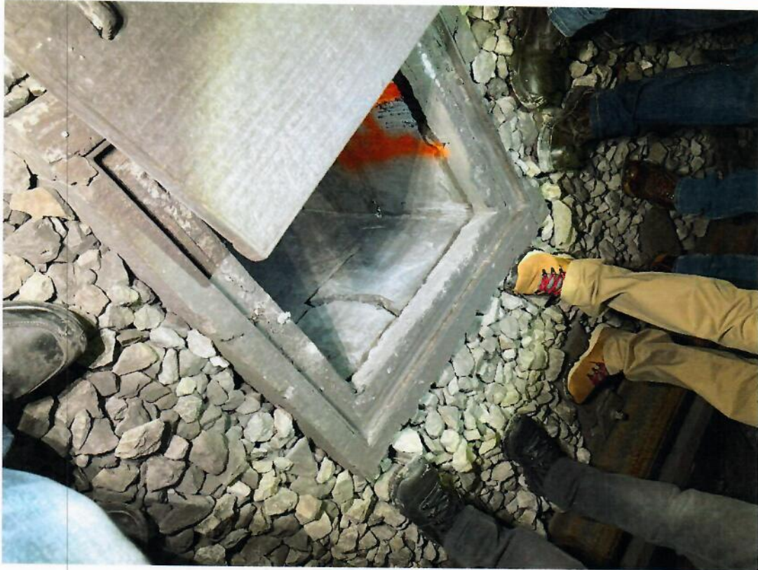
Fotografía 15. Daños estructurales en las paredes del registro ubicado en el encadenamiento 25+180. A largo plazo, la pared del registro fallará y el balasto obstruirá el sistema hidráulico.
