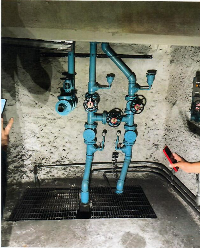
Fotografía 14. Estado actual del cárcamo de bombeo ubicado en el cadenamiento 24+880. Pese a los tirantes existentes en algunos tramos del túnel, las bombas del cárcamo no estaban operando debido a su bajo nivel hidráulico.
