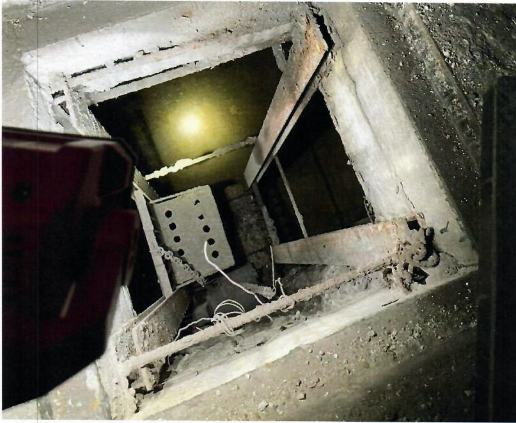
Fotografía 13. Estado actual del cárcamo de bombeo ubicado en el cadenamiento 24+880.
