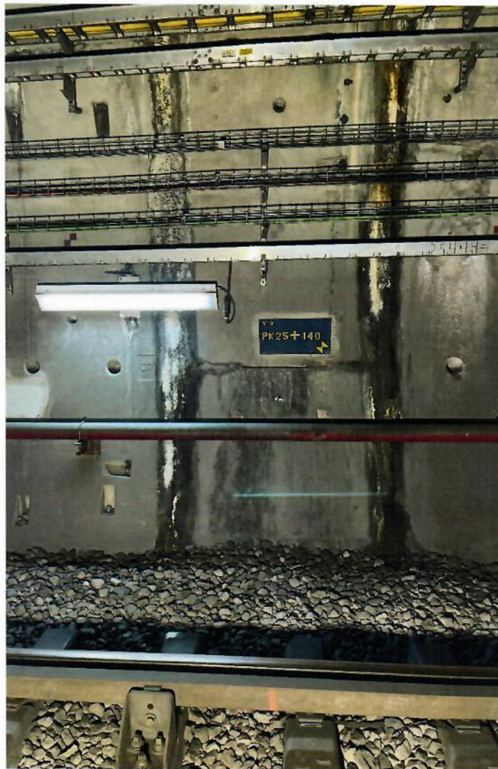
Fotografía 8. Filtraciones entre juntas a la altura del cadenamiento 25+140.
