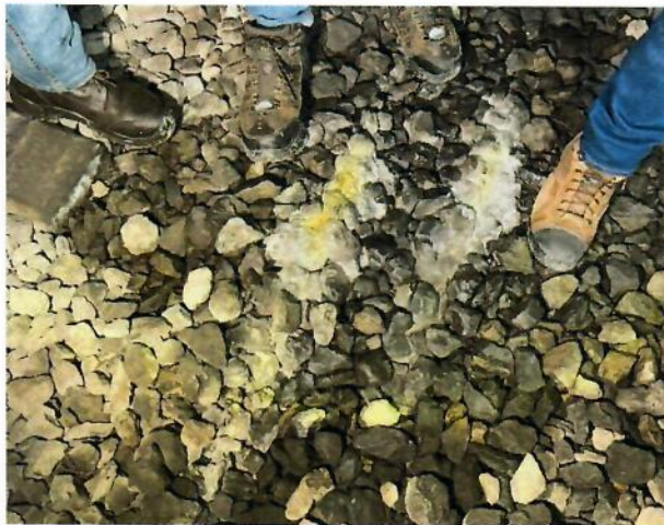
Fotografía 3. Daños causados por filtraciones, se observa la generación de sulfatos sobre el balasto, lo cual indica la presencia constante de agua en esta zona.
