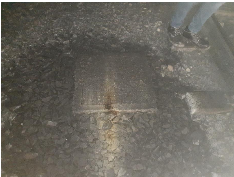
Figura 13 Filtraciones con fuerte goteo de agua, cadenamiento 25+470
