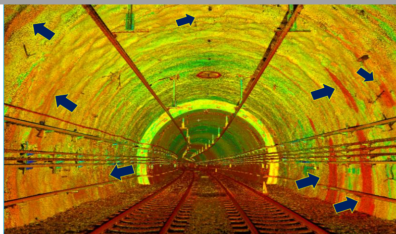
ZONA DE FILTRACIÓN 1 Cad. PK. 27+340 tramo Insurgentes Sur – Hospital 20 de Noviembre
