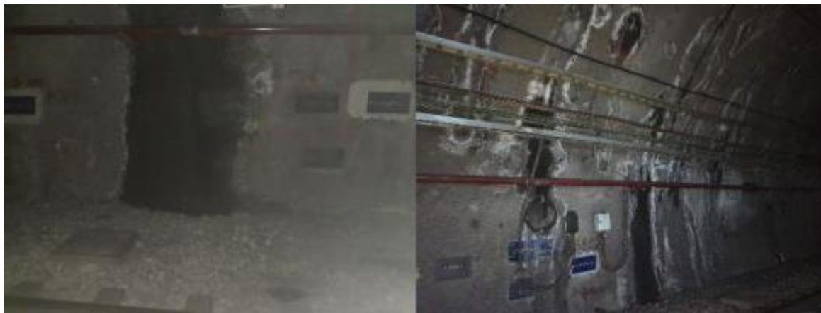
Figura 9. Filtraciones presentes en las paredes del túnel.
