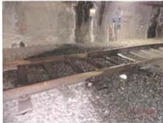
Foto 17: Filtraciones en el PK 27+393
