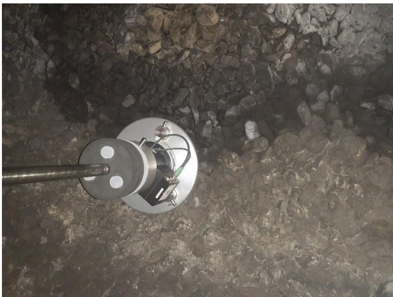
Figura 11 LWD en punto con filtraciones agua, cadenamiento 26+320.
