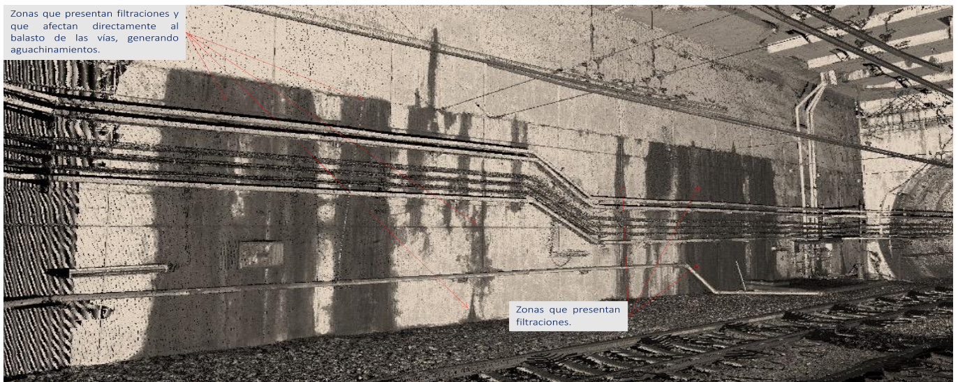
Esquema que muestra las zonas con filtraciones del tramo PK. 20+345 de la zona de transición
