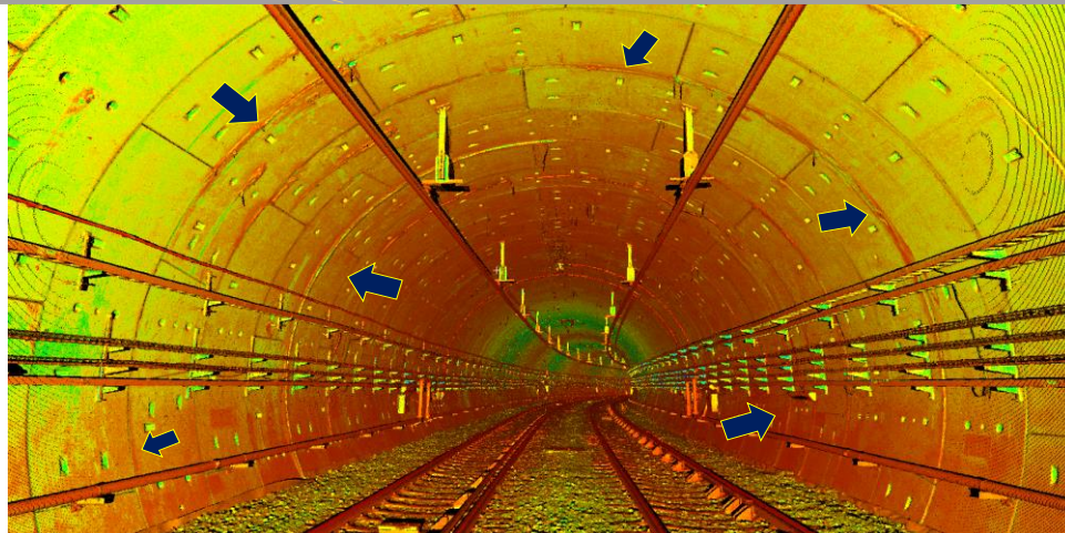
ZONA DE FILTRACIÓN 2 Cad. PK. 25+721 tramo Zapata – Parque de los Venados
