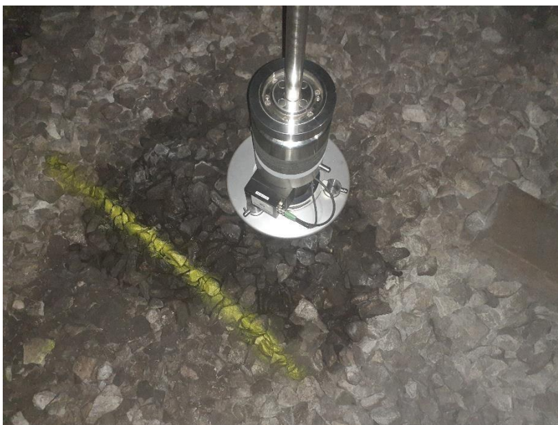
Figura 12 LWD en punto con filtraciones de agua, cadenamiento 25+470.
