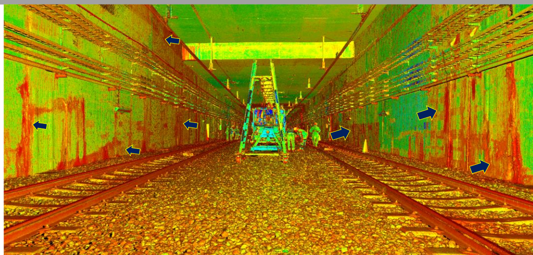
ZONA DE FILTRACIÓN 1. Dentro de las Filtraciones, existen fisuras sobre la estructura Cad. PK. 18+376 tramo Atlalilco – Portal Oriente Tunnel
