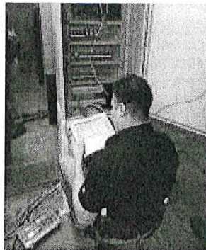
Implementación del sistema de mando centralizado
