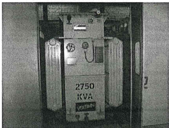
Transformador de potencia en Subestaciones de Rectificación de 15,000 volts.
