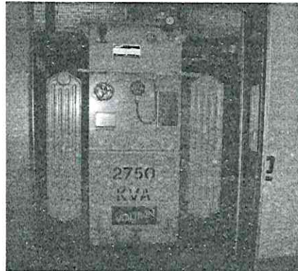
Transformador de potencia de 2750 KVA 15,000 volts de las Subestaciones de Rectificación de Línea 1.
