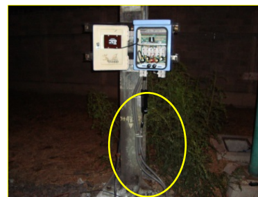
Caja con cableado hacia vías
