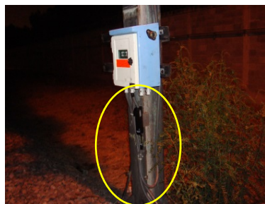
Caja con cableado hacia las vías
