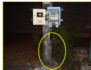
Caja con cableado hacia vías
