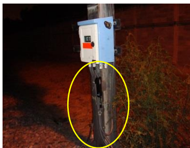
Caja con cableado hacia las vías
