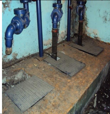
Sustituir tapas y marcos
