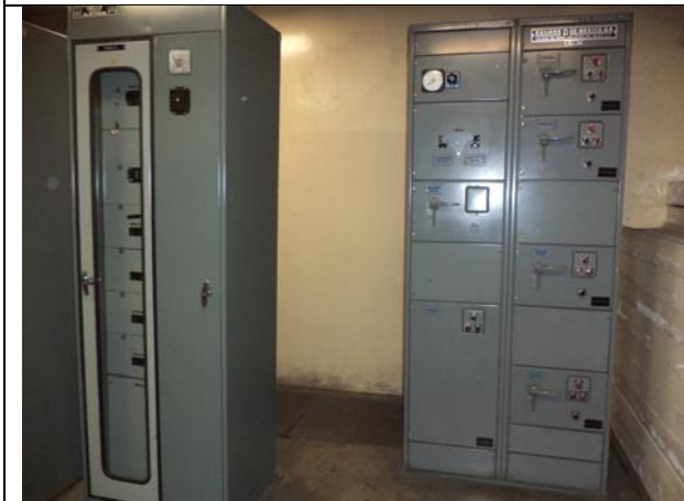
Sustitución del centro de control de motores y transferencia automática en la subestación eléctrica, instalando un tablero de distribución en donde se encuentren todos los interruptores de los equipos de bombeo de la estación "TABLERO F", con alimentación PREFERENCIAL.
