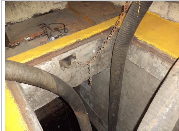
Sustitución de marcos y tapas de registro, mangueras de succión, cadenas soportes
