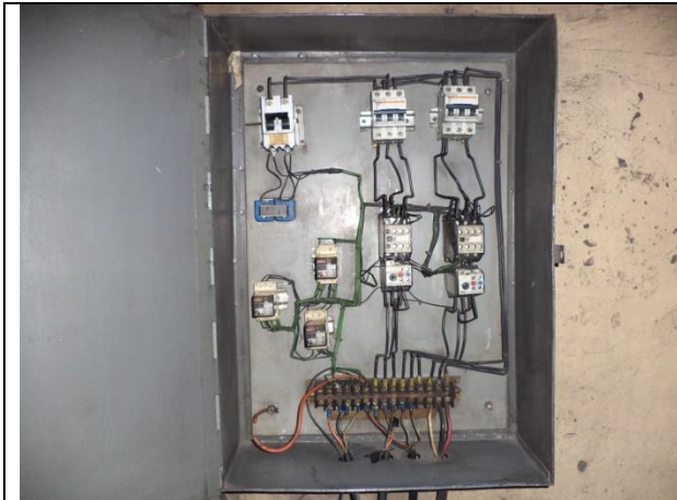
Sustitución de tablero de control y fuerza, cables de alimentación, tuberías conduit.
