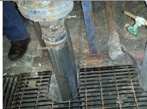
Sustitución de: mangueras; soportes para tuberías de descarga y arreglo hidráulico; tapas y marcos de registros
