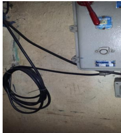
Sustitución de los cableados de alimentación trifásica a 220 volts, más un hilo de tierra, desde la subestación eléctrica hasta el tablero de control y fuerza.
