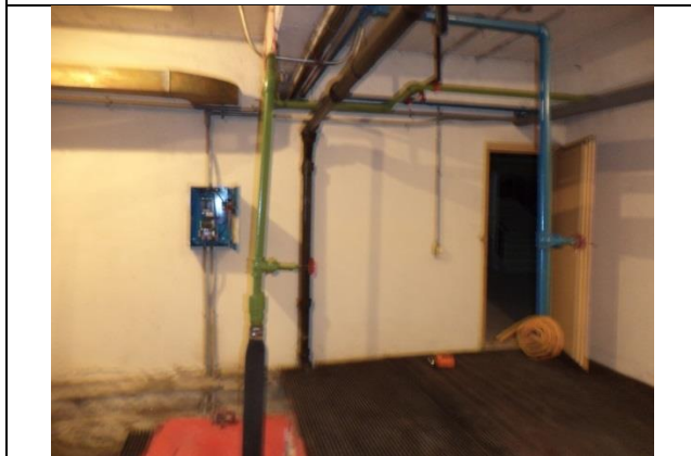
Sustitución de tuberías de descarga, arreglo hidráulico y mangueras de descarga y soportería
