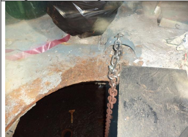
Sustituir brocal, tapa de registro cadena y soporte para cadena y electrodos de nivel
