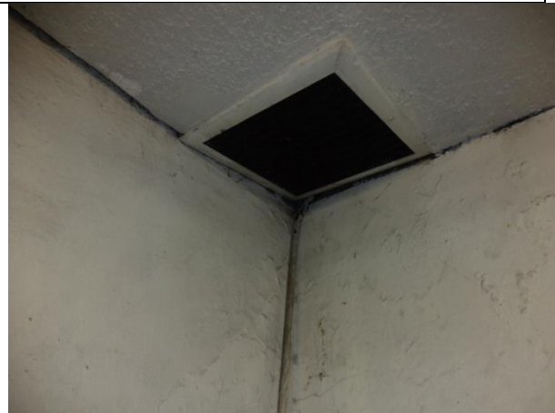
Sustituir regillas de extracción y canalizar descarga hacia el exterior
