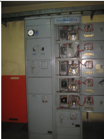
Sustitución del centro de control de motores y transferencia automática en la subestación eléctrica, instalando un tablero de distribución en donde se encuentren los interruptores de equipos de bombeo de la estación "TABLERO F", con alimentación PREFERENCIAL.
