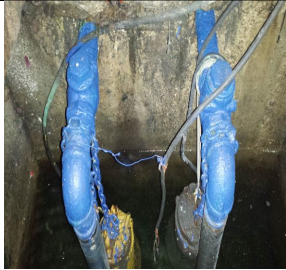
Sustitución de cadenas para las maniobras con las motobombas
