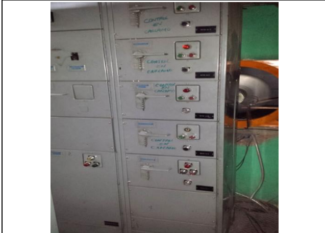
Sustitución del centro de control de motores y transferencia automática en la subestación eléctrica, instalando un tablero de distribución en donde se encuentren todos los interruptores de los equipos de bombeo de la estación "TABLERO F", con alimentación PREFERENCIAL.
