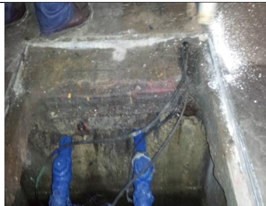
Sustituir tapas y marco del registro de acceso al cárcamo
