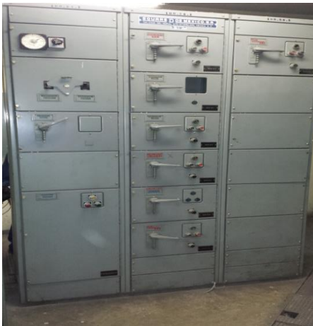
Sustitución del centro de control de motores y transferencia automática en la subestación eléctrica, instalando un tablero de distribución en donde se encuentren todos los interruptores de los equipos de bombeo de la estación "TABLERO F", con alimentación PREFERENCIAL.
