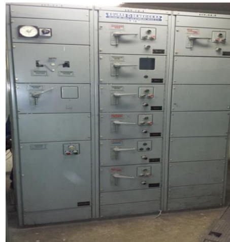
Sustitución del centro de control de motores y transferencia automática en la subestación eléctrica, instalando un tablero de distribución en donde se encuentren todos los interruptores de los equipos de bombeo de la estación "TABLERO F", con alimentación PREFERENCIAL.
