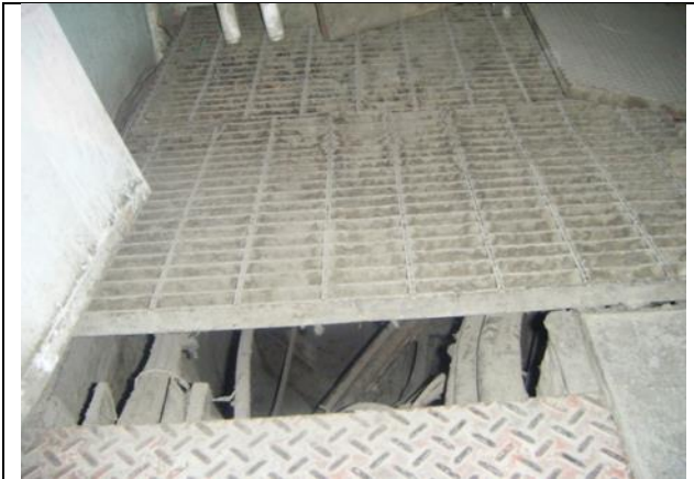
Sustitución de los cableados de alimentación trifásica a 220 volts, más un hilo de tierra, desde la subestación eléctrica hasta el tablero de control y fuerza.
