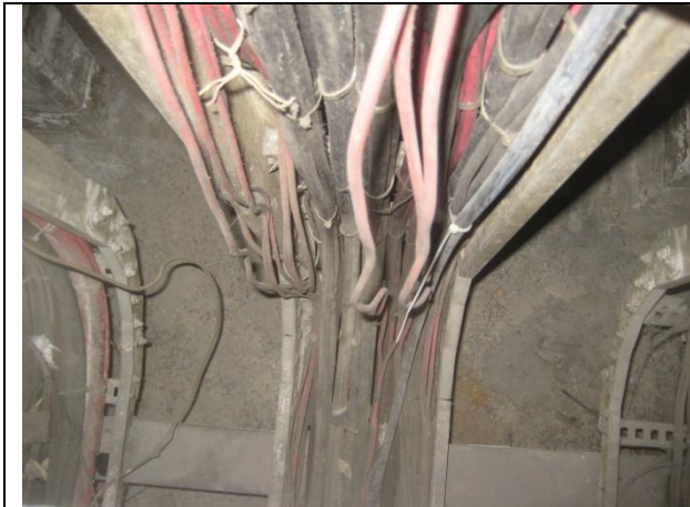
Sustitución de los cableados de alimentación desde la subestación eléctrica hasta el tablero de control y fuerza, trifásica a 220 volts, e hilo de tierra.
