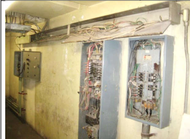
Reordenar y modernizar los tableros de alumbrado y fuerza
