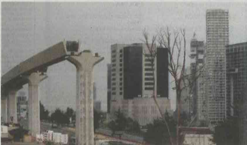
Para continuar con los trabajos la SCT transfirió 5 mil 59 millones 662 mil pesos a la administración capitalina encargada de ese tramo.
