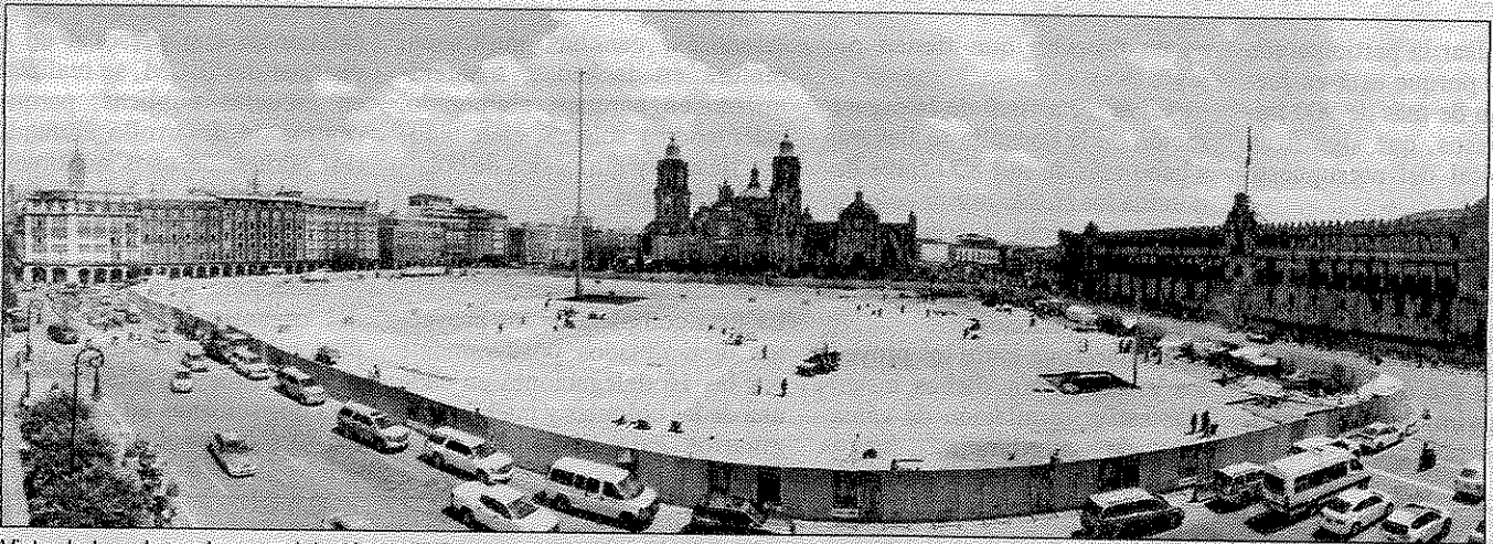
Vista de las obras de remodelación de la Plaza de la Constitución ■ Foto La Jornada
