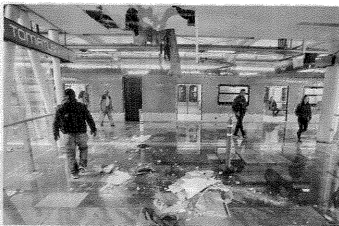
Los plafones en la Estación San Andrés Tomatlán se vencieron ante la presión de las filtraciones.
